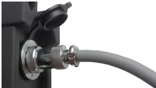
Рисунок 2.1 – Подключение высоковольтного трансформатора-держателя
