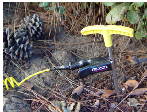
Рисунок 6 – Зажим подводящего провода, подсоединенный к заземляющему стержню
