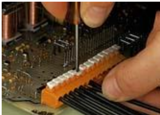
Рисунок Н.3 – Использование клеммных зажимы WAGO серии 235 для монтажа кабеля
